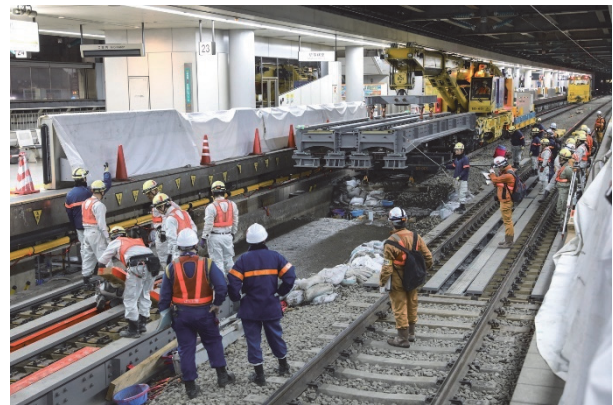
写真-1 操重作業車による工事桁架設状況 (隣接線使用可能箇所)
